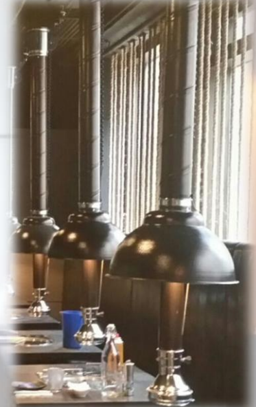
韓式抽氣煙通 Exhaust pipe
