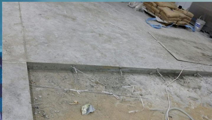
冷庫內地台 COLD ROOM PLATFORM
